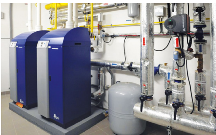
Plynová kotelna v pavilonu Bumbálek ZŠ Špitálská
